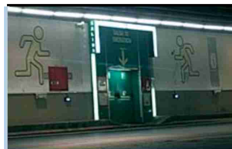
Salida de emergencia en uno de los nuevos túneles. M. BILBAO
